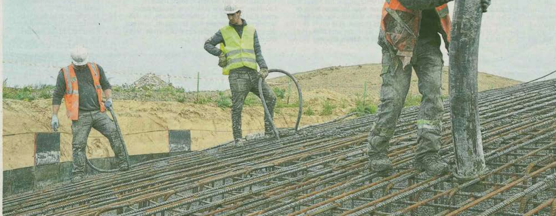
C'est la société Gecitec de Rouvroy, au sud d'Hénin-Beaumont, qui s'occupait de la coulée de la fondation.
